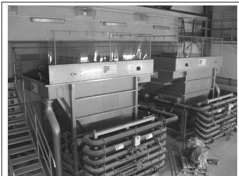
Obr. 2. Flotace kalového hospodářství na ÚV Souš
